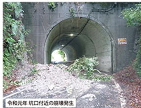
令和元年 坑口付近の崩壊発生
