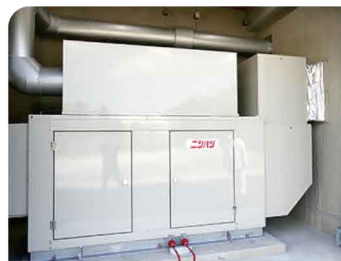
防災用自家発電設備
