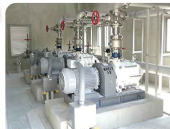
1・2・3号送水ポンプ室
