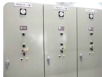
1・2・3号送水ポンプ盤
