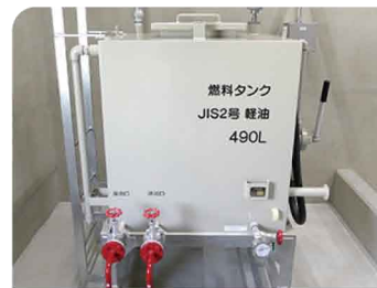
自家発電用燃料タンク
