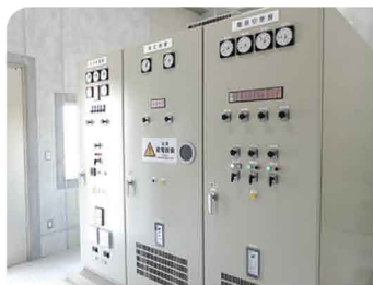
引込受電盤・変圧盤・電源切替盤
