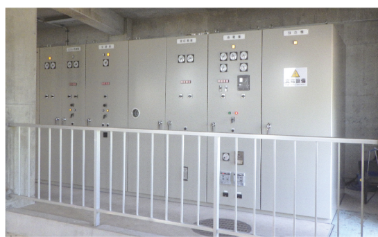
湯島排水機場高圧受電設備改修工事
