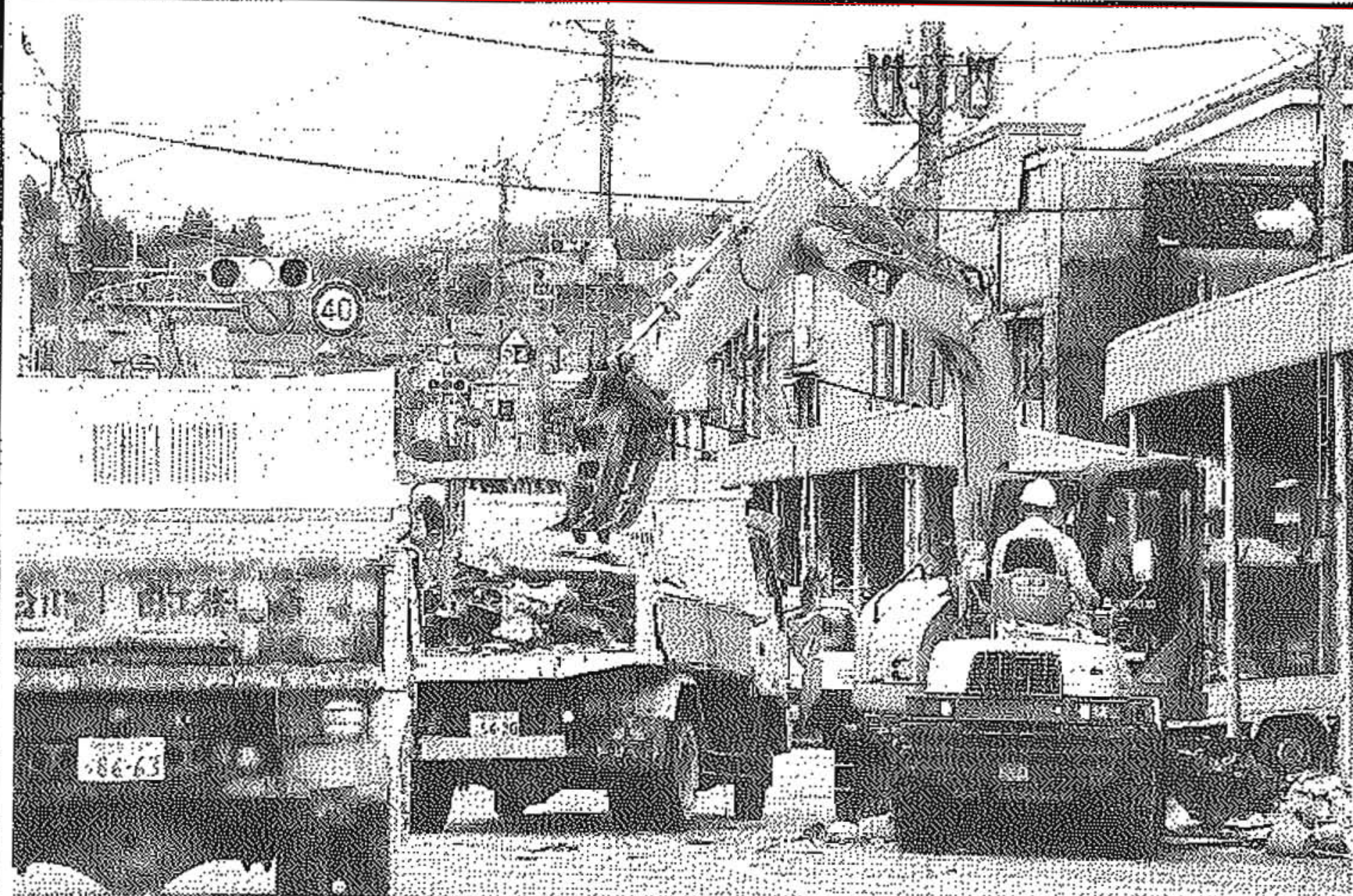
被災地で復旧に取り組む建設業 ＝さつま町虎居地区の商店街で
